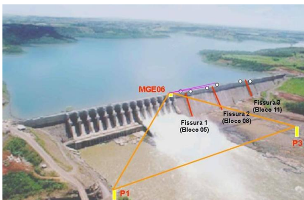
Figura 2 – Rede Externa de Monitoramento das fissuras a Montante
