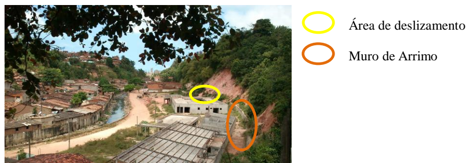
Figura 1 – Rompimento do muro de arrimo próximo à construção de obras do município. Fonte: Autor
