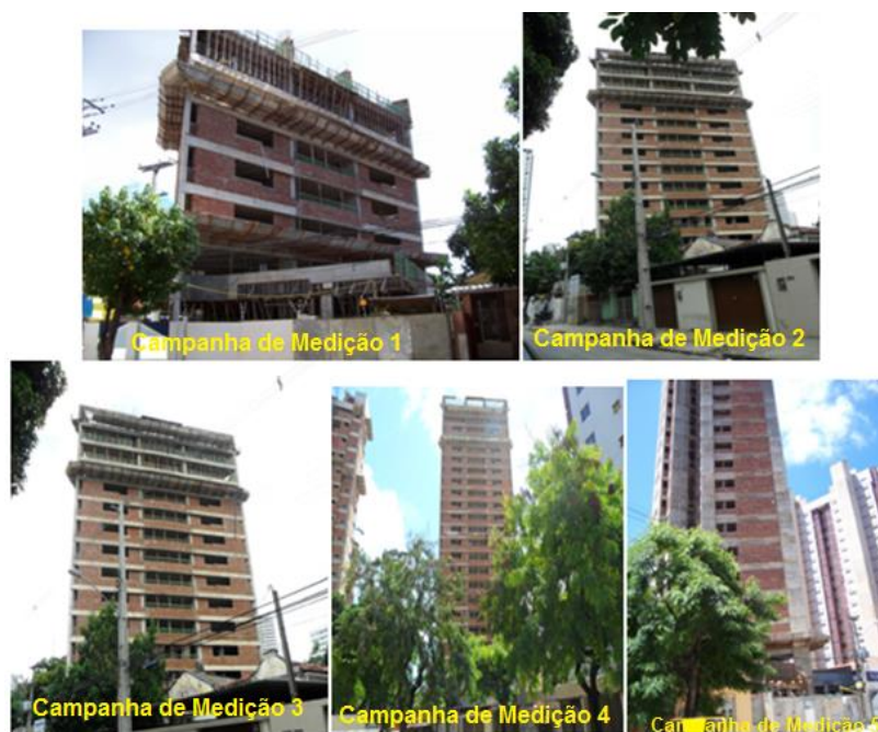
Figura 6 – Estado da edificação, nas diferentes épocas das campanhas de medição. FONTE: Araújo; Seixas (2013).
