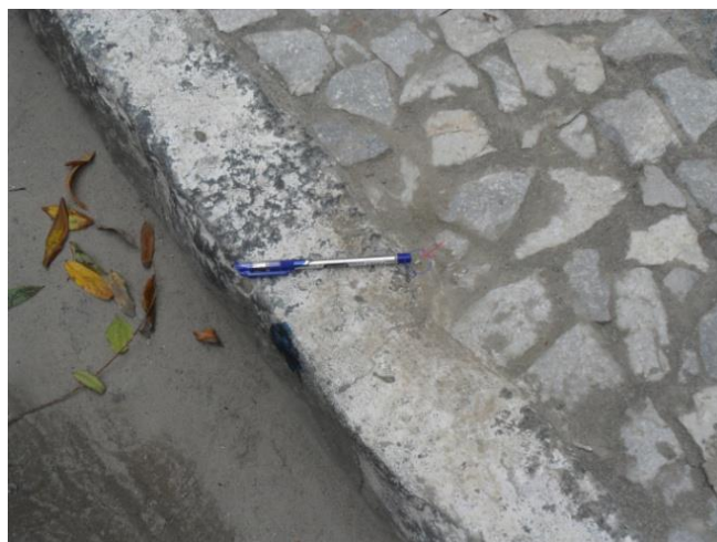
Figura 1 – Exemplo de pino cravado entre os meios fios e próximo à edificação.
