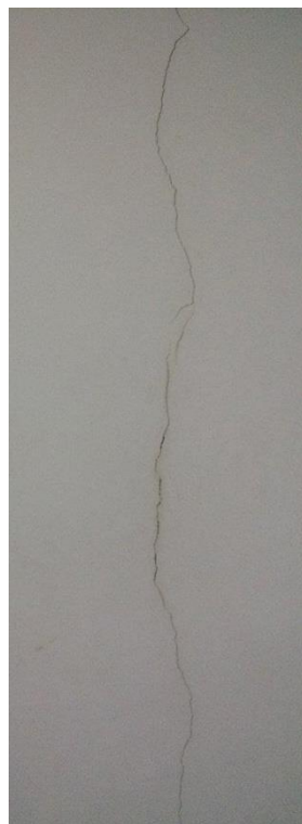
Figura 3: Segunda área de estudo, parede do prédio do departamento de Engenharia Civil – UFV.
